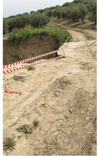
Zona afectada. AYTO.
