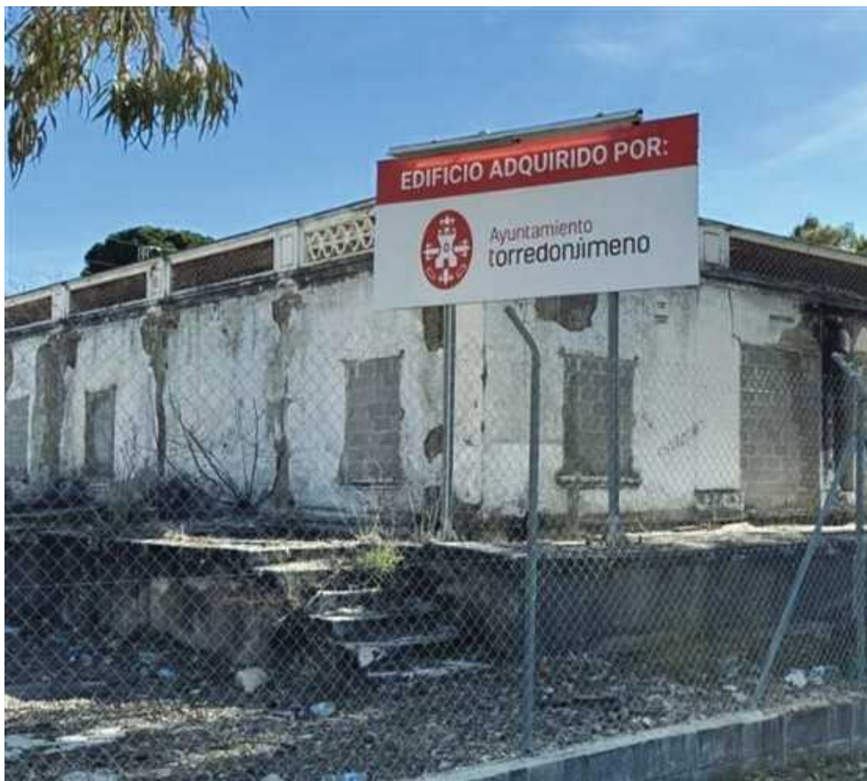
Estado actual de la nave del Comunal Olivarero. PARTIDO POPULAR DE TORREDONJIMENO.
